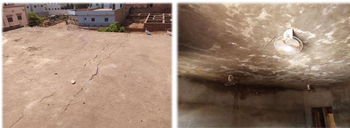
De scheuren in het dak aan de buitenkant en het plafond binnen.
